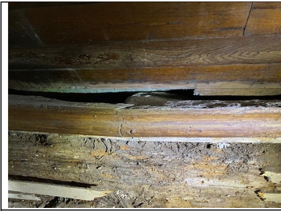
Zone de lambris désassemblé à conforter, corniche à refixer (partie Sud/Ouest)
