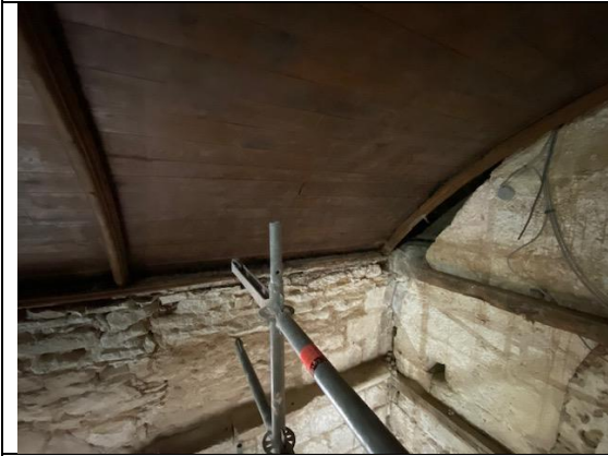
Corniche du chœur à refaire selon modèle existant.
